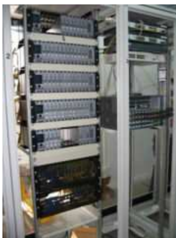
Przykład Regionalnej Stacji czołowej
